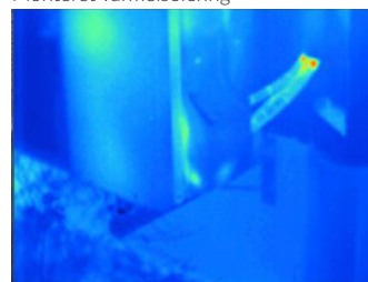
DanmarksPumpen med varmeisolering
